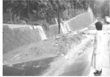
現地を視察 尺代 土砂流出の
